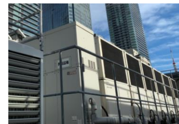
屋上の省エネ設備
